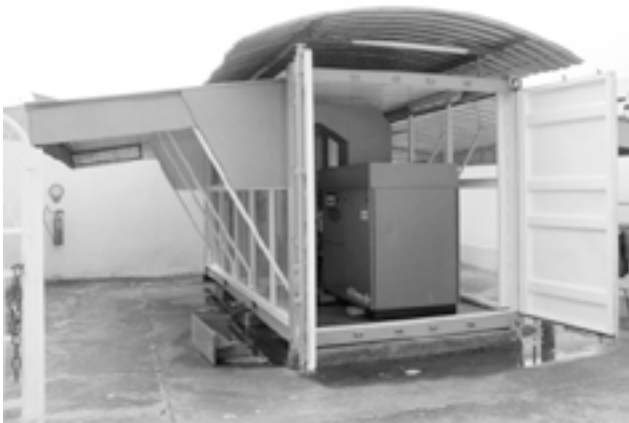
Figure 5 - Centrale de production d'O 2 PSA dans un container, à l'Hôpital communautaire de Bangui (RCA). Matériel de On Site Gaz International OSGINT. Exploitée par SOCACI, Société Centrafricaine des gaz industriels.
