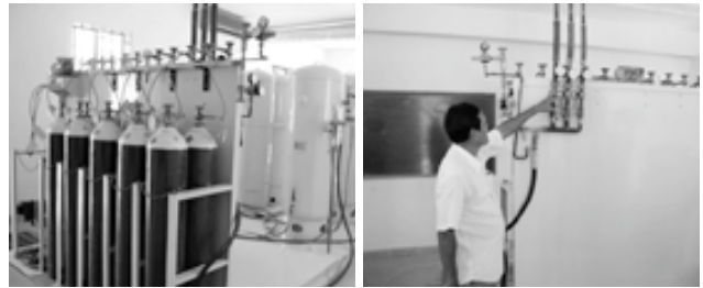
Figure 7 - Centrale de production d'O 2 PSA à fort débit, à l'Hôpital Calmette de Phnom Penh (Cambodge), permettant de remplir des bouteilles et d'alimenter le circuit de l'hôpital (blocs opératoires, réanimation). Matériel AirSep
