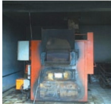
Figure 8 : Incinérateur d'un hôpital public
